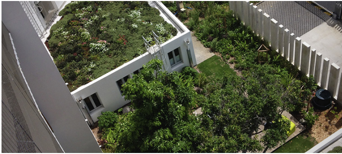
Toitures terrasses végétalisées @Groupe Fages Siège de la SEMADER - Siège du TCO
